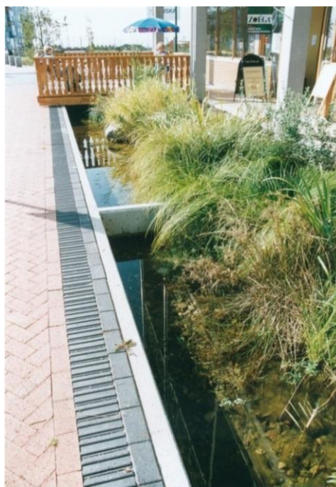
Figur 20. Avvattning som utformats som en liten kanal där en rain garden fördröjer och renar dagvatten.
